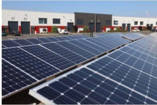
Panneaux solaires au sol / Mascara (Vergnet).
